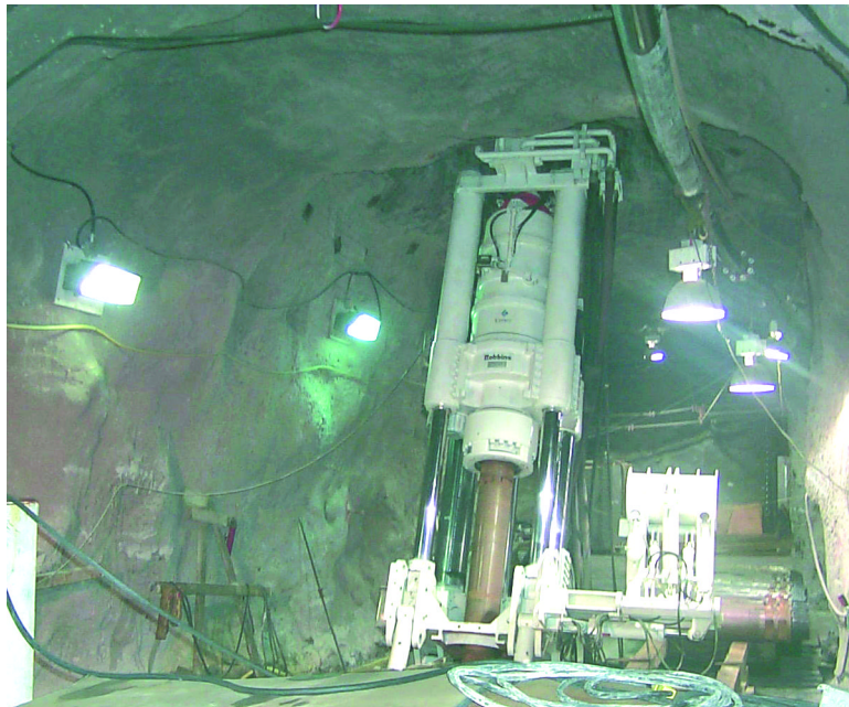
Photo 1 - Atelier d'abattage du minerai à très haute teneur par "gros trou" ("raise boring"); mine de McArthur River, Saskatchewan, Canada
