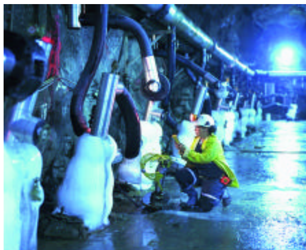
Photo 2 - Galerie de congélation d'une zone en exploitation ; mine de McArthur River, Saskatchewan, Canada
